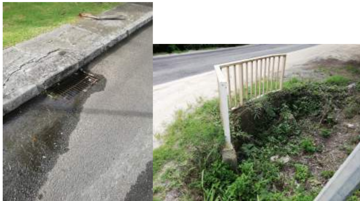
FIGURE 110 : OUVRAGES DE COLLECTE DES EAUX PLUVIALES PRESENTS LE LONG DE LA RD118 (EGIS, OCTOBRE 2020)
