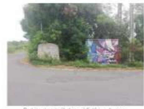
Cable et poste électrique à l'intérieur du virage
