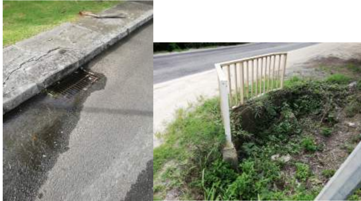
Figure 26 : Exemple d'ouvrages de collecte des eaux pluviales présents le long de la RD118
